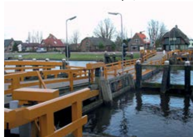
De vlotbrug in het Noordhollandsch Kanaal in Koedijk, grotendeels in originele staat.
